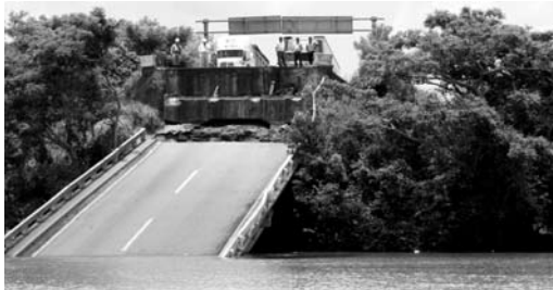
Lluvias afectan carreteras y obstruyen al autotransporte.
